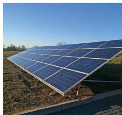
Instalacja naziemna, Kraków
