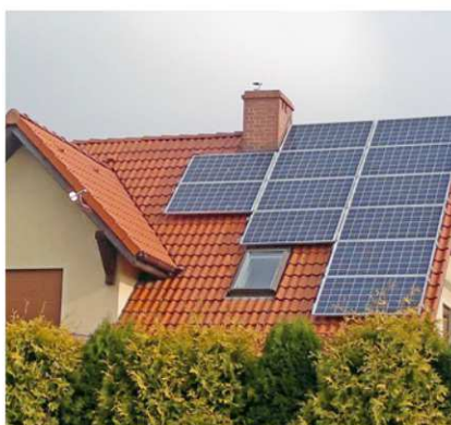
Dom prywatny w Gliwicach, moc 4,5 kWp
