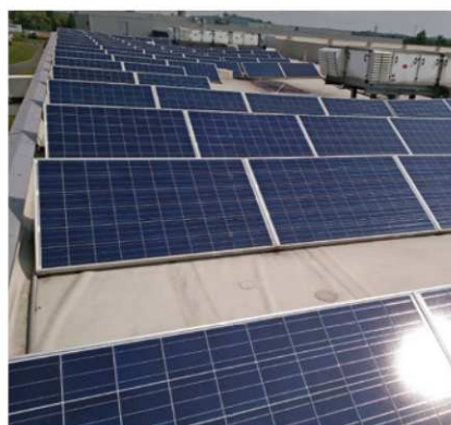
Hala przemysłowa w Bieruniu 21,5 kWp
